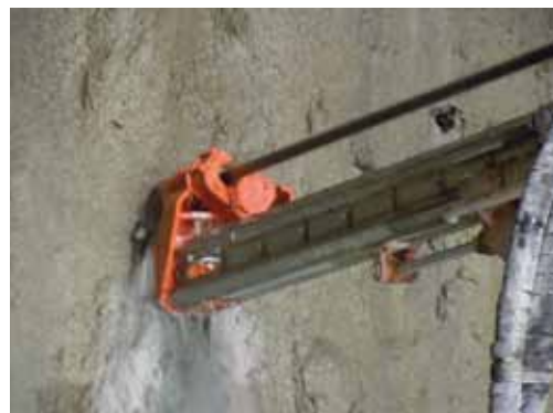
Particolare di un foro
